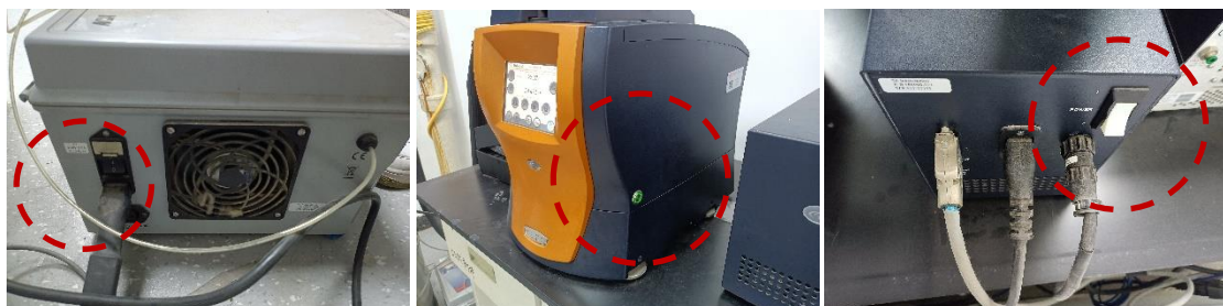
从左到右依次为气泵、主机、电源控制器开关
